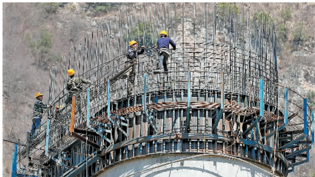
成昆铁路扩能改造工程峨米段六标段的铁路建设者正在为位于甘洛县苏雄乡埃岱村境内的尼日河2号双线特大桥梁安装桥墩模板。
